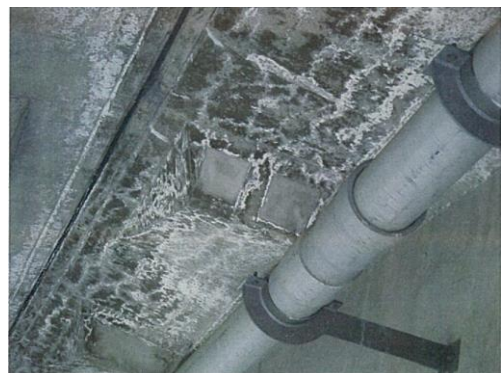
写真-1 PC 床版(下面張出し部)の劣化状況
