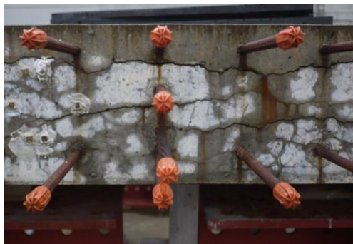
(b) 端面の水平ひび割れ
