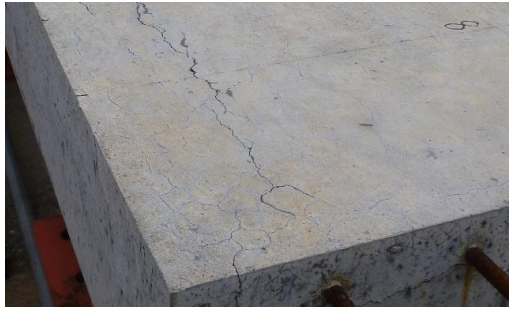
(a) PC 鋼材に沿ったひび割れ
