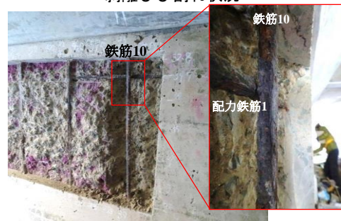
写真-3 鉄筋 10 付近交差箇所の鉄筋腐食状況
