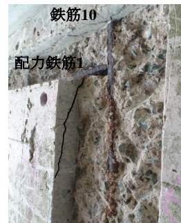
写真-2 鉄筋 10 付近切断面部の配力鉄筋の剥離ひび割れ状況
