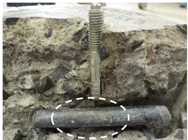
写真-2 内部鉄筋の発錆状況 (芯棒打込み式・中性化13週+塩水13週)
