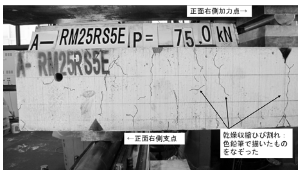
写真 1 乾燥収縮ひび割れの発生状況
