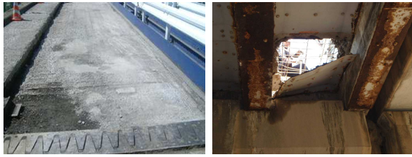
(1) 土砂化 (2) 抜け落ち 6) 写真-1 伸縮継手付近の損傷状況の一例
