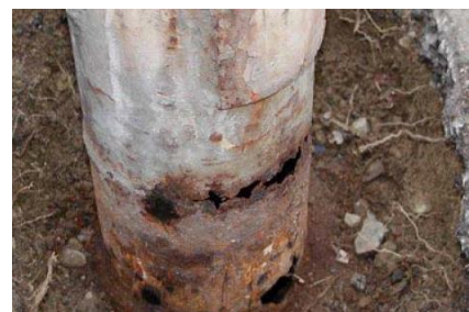
図-1 地際部の腐食の様子 2)
