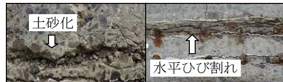
(1) 床版内部の土砂化 (2) 水平ひび割れ
