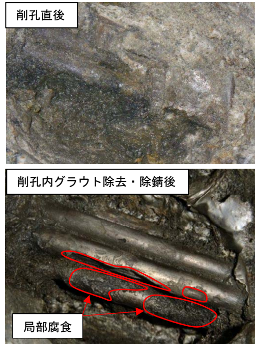
写真-1 G6 桁の主ケーブル腐食状況
