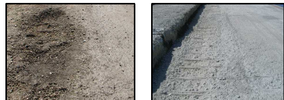
(1) RC床版上面の土砂化 (2) 土砂化によるスケーリング
