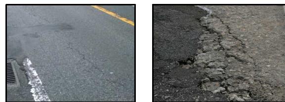
(1) 5mm程度のひび割れ (2) 補修箇所の再劣化
