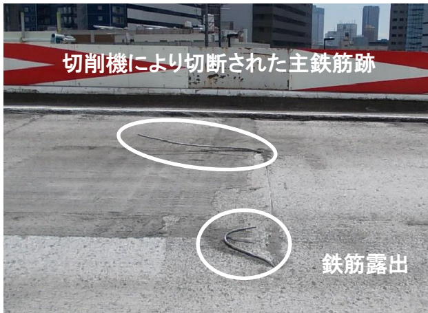
写真-1 床版上面の鉄筋露出
