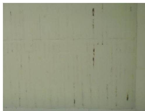
写真-2 塗膜の変色状況 (U1 工法)
