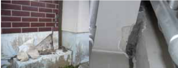
(a)基礎ばり周辺 (b)Exp. 付近 写真 - 1 地震による被害例
