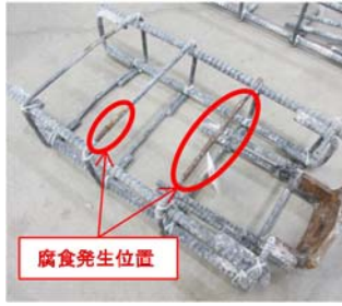
図-14 鋼材腐食状況（塩水噴霧）
