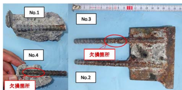
図-13 鋼材腐食状況(乾湿繰返し)
