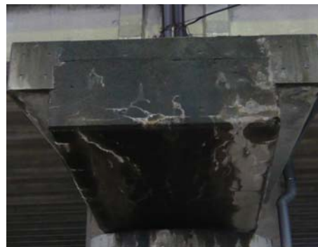
写真-1 ASR 発生構造物の状況（無害判定骨材使用）
