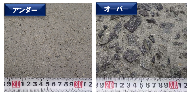
写真-4 粗骨材の露出状態（悪い例）
