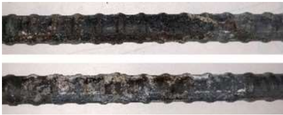
図-10 解体時の鉄筋の腐食状況 (気中養生, w/c=55\% , \text{NaCl}=0\text{kg}/\text{m}^3 , 腐食有)
