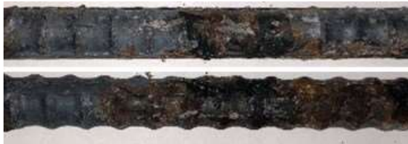
図-12 解体時の鉄筋の腐食状況 (気中養生, w/c=55\% , \text{NaCl}=10\text{kg}/\text{m}^3 , 腐食有)
