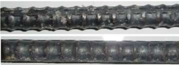
図-13 解体時の鉄筋の腐食状況 (湿布養生, w/c=40\% , \text{NaCl}=0\text{kg}/\text{m}^3 , 腐食有)
