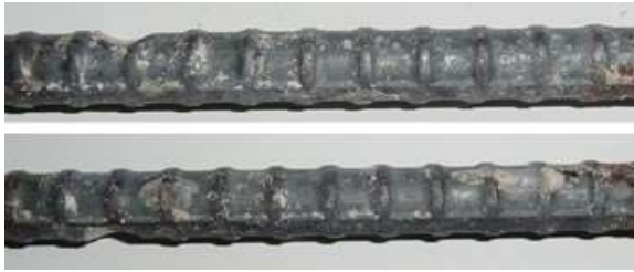
図-9 解体時の鉄筋の腐食状況 (気中養生, w/c=40\% , \text{NaCl}=0\text{kg}/\text{m}^3 , 腐食有)
