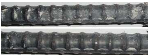
図-14 解体時の鉄筋の腐食状況 (湿布養生, w/c=55\% , \text{NaCl}=0\text{kg}/\text{m}^3 , 腐食無)
