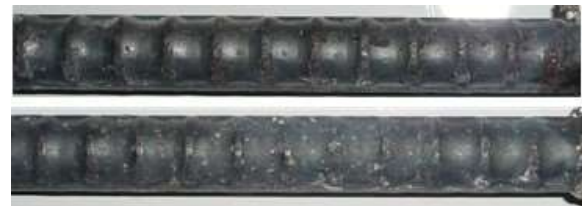
図-16 解体時の鉄筋の腐食状況 (湿布養生, w/c=55\% , \text{NaCl}=10\text{kg}/\text{m}^3 , 腐食有)
