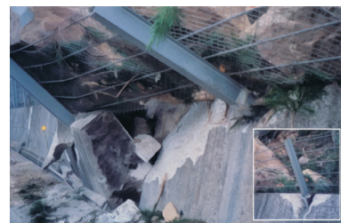
写真-1 支柱基部の損傷例 3)
