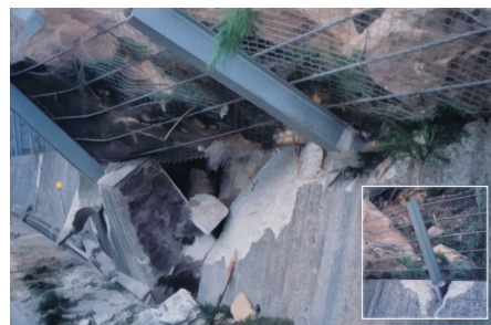
写真-1 支柱基部の損傷例 2)
