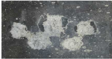
写真-1 目荒らし面の破壊状況
