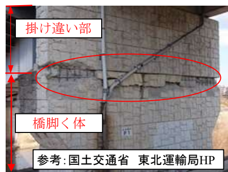
図-1 掛け違い部の損傷 1)
