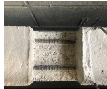
(b) 断面欠損部
