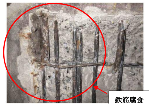
写真-6 はつり箇所の鉄筋腐食状況 (隅田川B線 13k163m)
