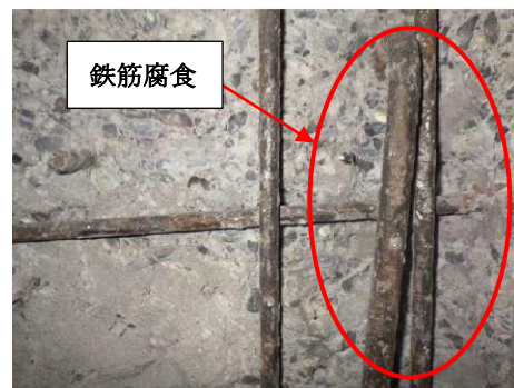
写真-5 はつり箇所の鉄筋腐食状況 (隅田川A線 13k165m)
