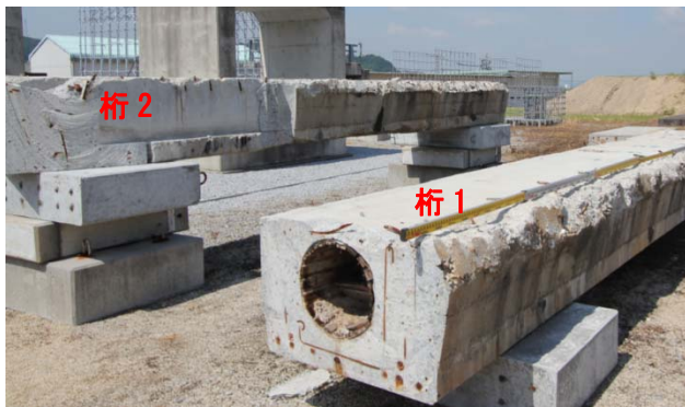
写真-2 塩害を受けて撤去されたPC桁
