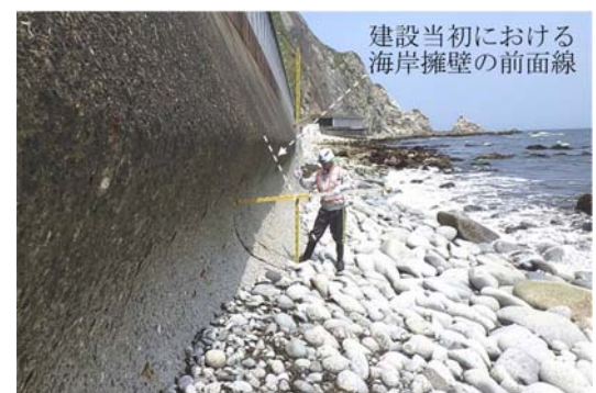
図-2 海岸擁壁コンクリートの浸食の状況
