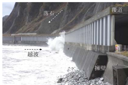
図-1 黄金道路における落石と越波の状況
