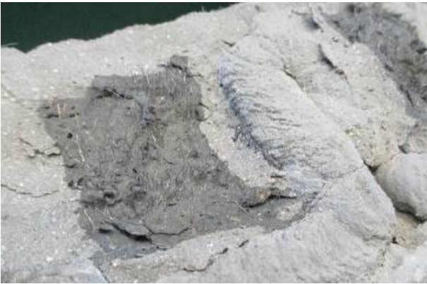
写真-8 破壊面の拡大 (No. 1)
