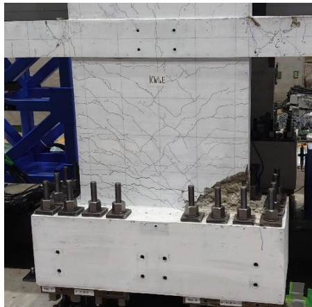
写真-2 最終破壊状況 (Y1 通り 1階壁 CW1)
